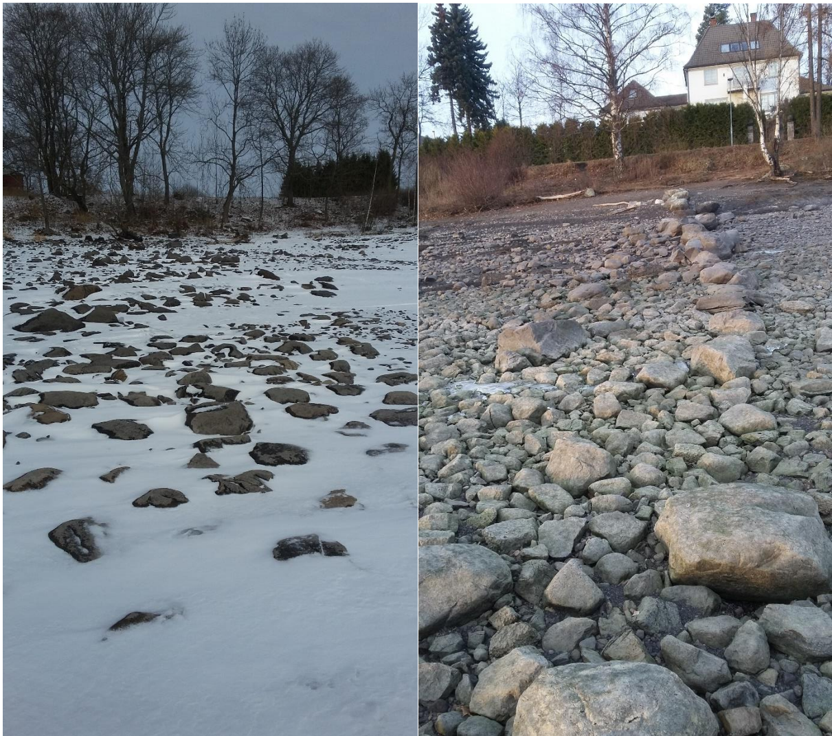
Figur 11: Til venstre stasbryggen nedenfor bispeborgen, til høyre bryggen nedenfor fisketorget. I hvilken grad forfallet skyldes erosjon og menneskelig påvirkning er uklart. Ingen av bryggene har samme struktur av flate tilpassede heller som bryggen i Nordvika. Foto mars 2017 og desember 2016
