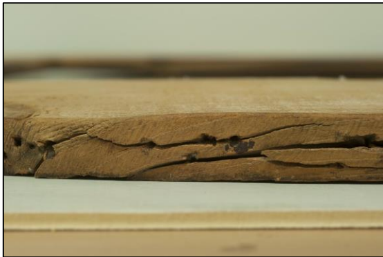
C Langsgående sprekker på ytterkantene
