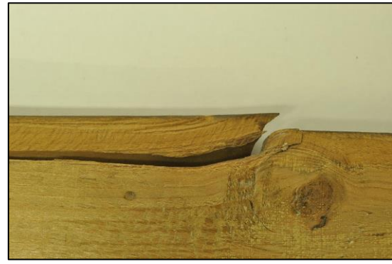
D Oppsprekking ved kvister
