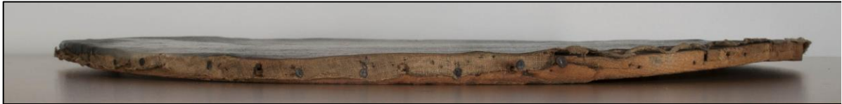
C. Oppspenningskanter langs nedre side og vridning i listen
