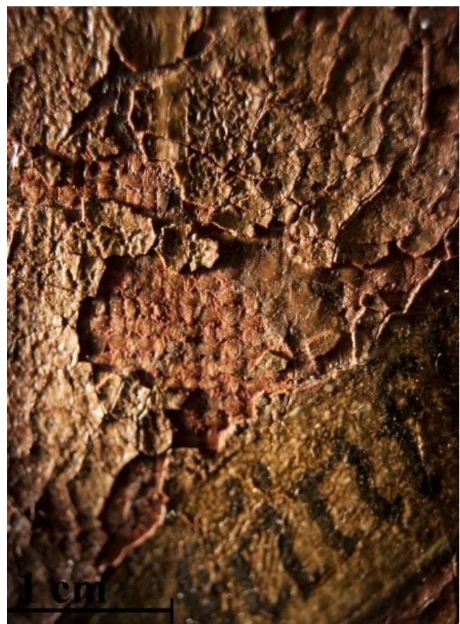
Fig. 64. Oppskalling og avskalling (sidelys).
