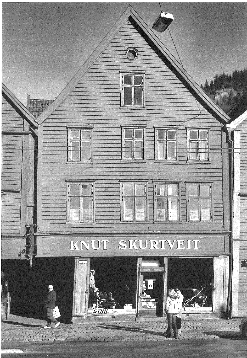
Fig 14. Dagens Bryggebebyggelse hvor en tydelig ser utglidningene i første etasje på grunn av at tverrveggene er kuttet. Foto: J. Olsen.
