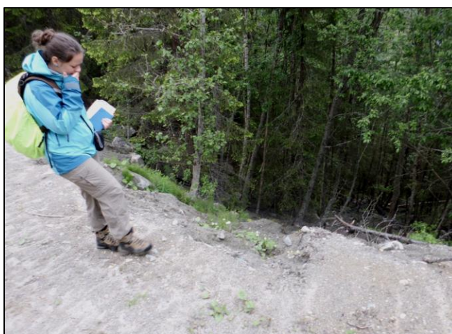
Figur 6-5. Forstørrelse av situasjonen i Figur 6-4. En utglidning som følge av avrenning langs veien på grunn av gjenfylte grøfter (Foto Yngvild S. Kvalvik).
