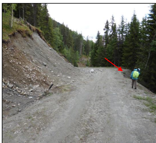
Figur 6-4. A: Oversiktsbilde over situasjonen i Figur 6-5 hvor pilen indikerer plasseringen av lokaliteten i figuren. Gjenfylte grøfter har ført til avrenning langs og over veibanen (Foto Yngvild S. Kvalvik).
