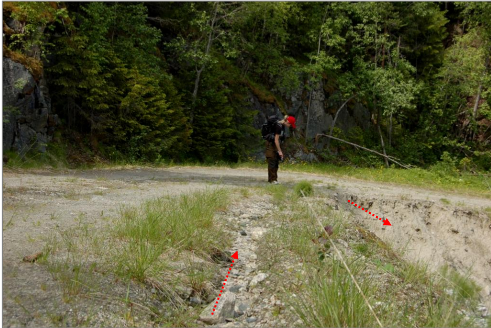
Figur 6-1. Skogsbilveien i Arnegårdslia. De røde pilene indikerer hvor vannet har fulgt veien og erodert i veimassene.
