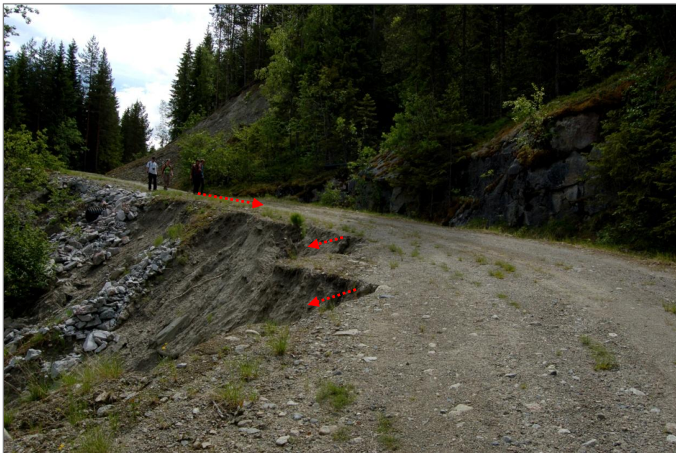
Figur 6-2. Følgebilde fra Figur 6-1. Erosjon i veimassene har ført til en utglidning i innersving.
