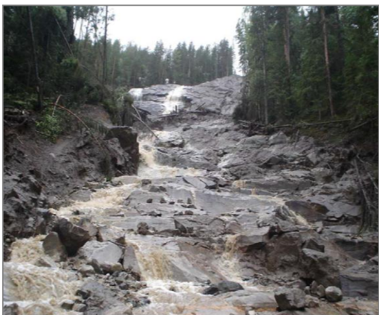
Figur 5-5. Skredet i 2007 ved Smedsgården Pensjonat. Bildet er tatt omtrent midt i skredløpet (Foto: Ørjan Nerland, NGI).
