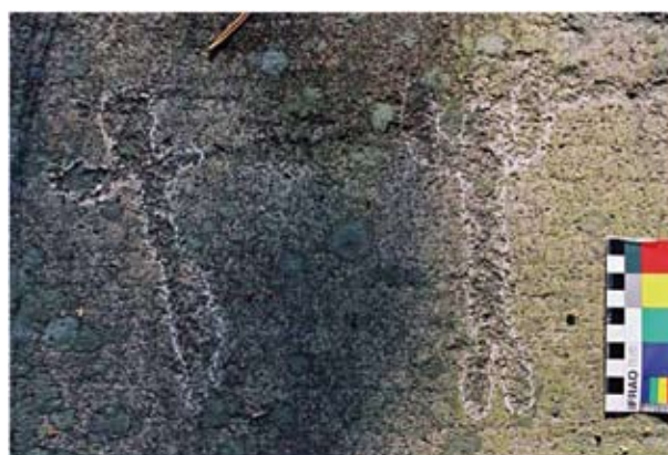
Figur 2_44: Nedre delen av Årum (lokal 41), vid skadedokumentationen i augusti 2004. Foto: Eva Ernfridsson.
