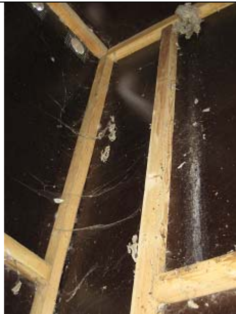
Bilde 12: Innsiden av kassen er møkkete, med spindelvev og vepsebol.
